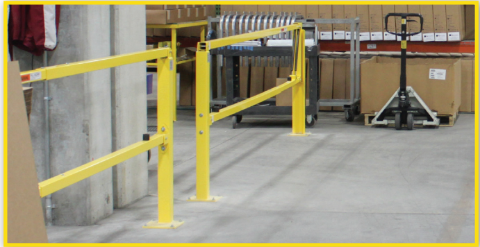
Contrôle des piétons au sol/protection périmétrique de zone
